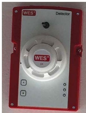
In allen Räumen wurden Rauchmelder installiert
